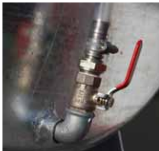
Jauge et vanne d'arrêt
