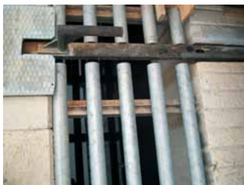
Chute du lisier sur grille «bovi-stop» pour fin de racleur. Ces grilles permettent le passage des véhicules.
